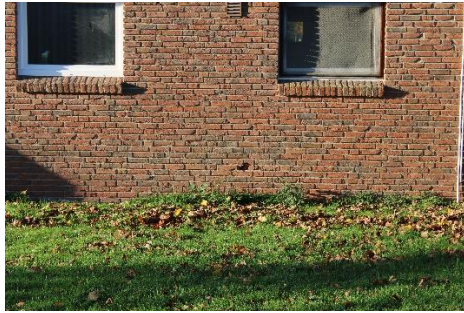
Abb. 31: Beschädigungen am Mauerwerk
