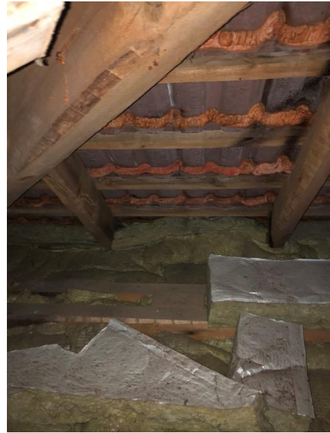
Abb. 27: Unregelmäßige Dämmung der OG
