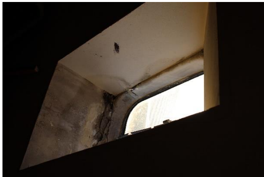
Abb. 26: Feuchtigkeitsschäden an den Dachfenstern
