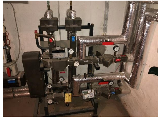
Abb. 32: Übergabestation im Sportlerheim
