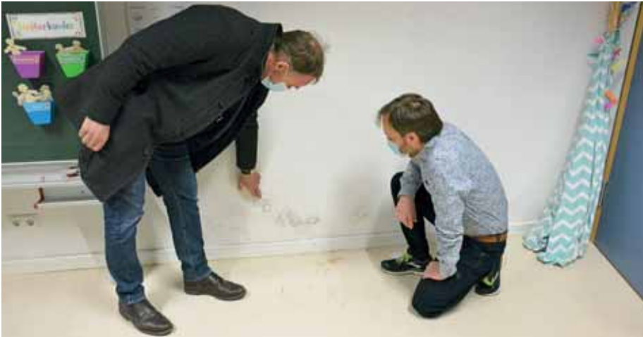
Diese Wasserschäden müssen behoben werden, Thomas Detlefsen (l.) und Wolfgang Schäffing betrachten eine der feuchten Wände
